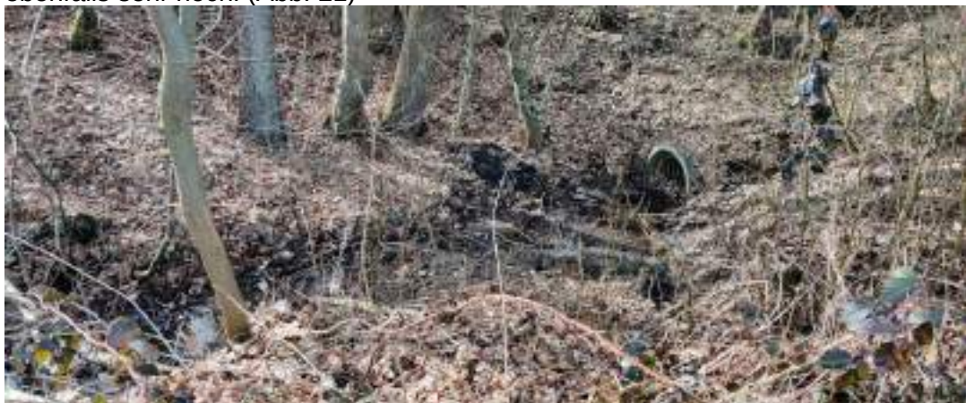
Abbildung 21: Einlaufbauwerk Staudenhäuser Graben
