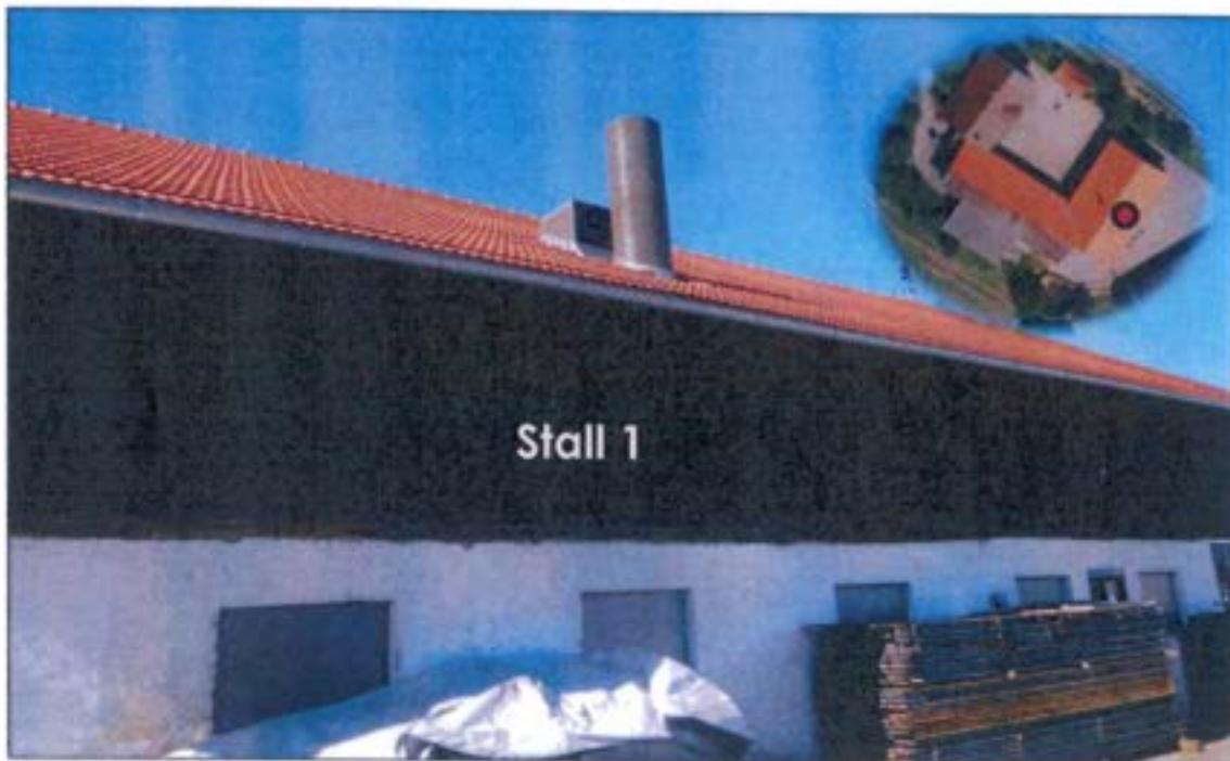
Abbildung 6: Abluftkamin an der östlichen Dachfläche des Stall 1
